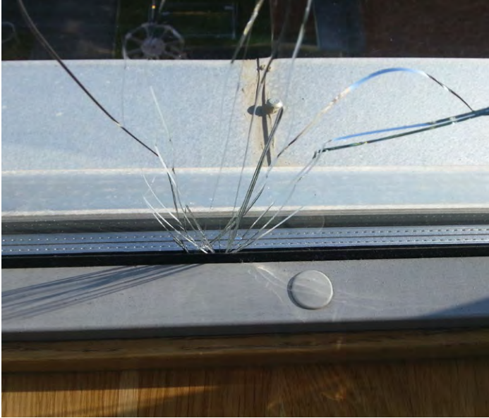
Bildet viser et karakteristisk mønster for termisk brudd i glass som ikke er herdet. Sprekken er vinkelrett ut fra skaden og sprer seg deretter i vifteform.
